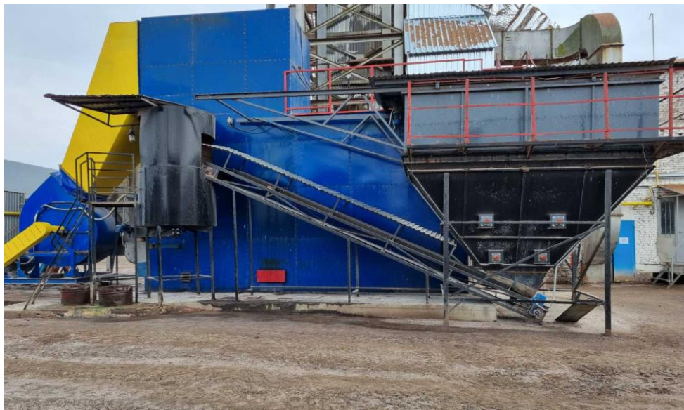
Рис. 1. Генератор-утилізатор потужністю 3 МВт
