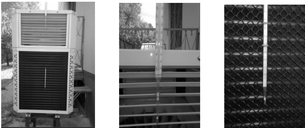
Рис. 2. Измерение температуры входящего и выходящего воздушных потоков теплового насоса THDTR600/R
