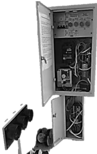
Рис. 8. Зовнішній вигляд електрощита з частотними перетворювачами.
