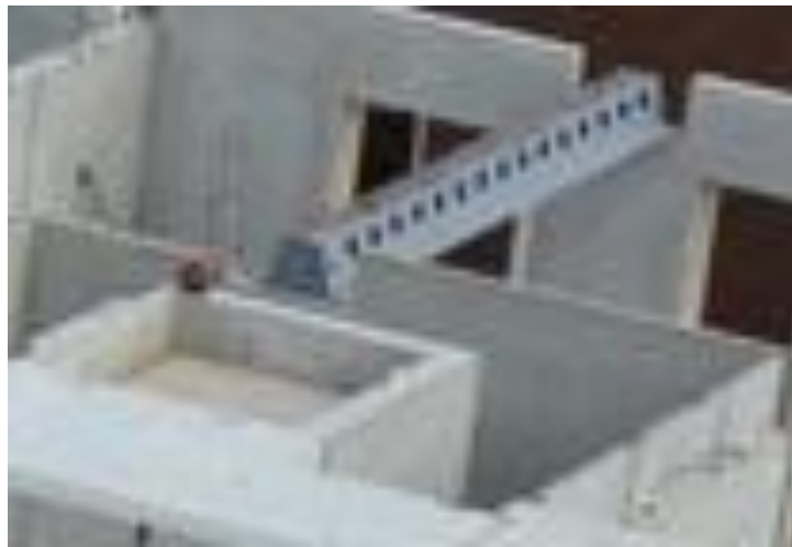
Рис. 1. Установка сталобетонної балки в крупнопанельній будівлі з подальшим монтажем на балку порожнистих плит [1].
