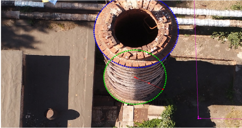
Рис. 4 – Загальний центр та діаметр вже сбудованою частиною відсутніх елементів нижнього кола труби
